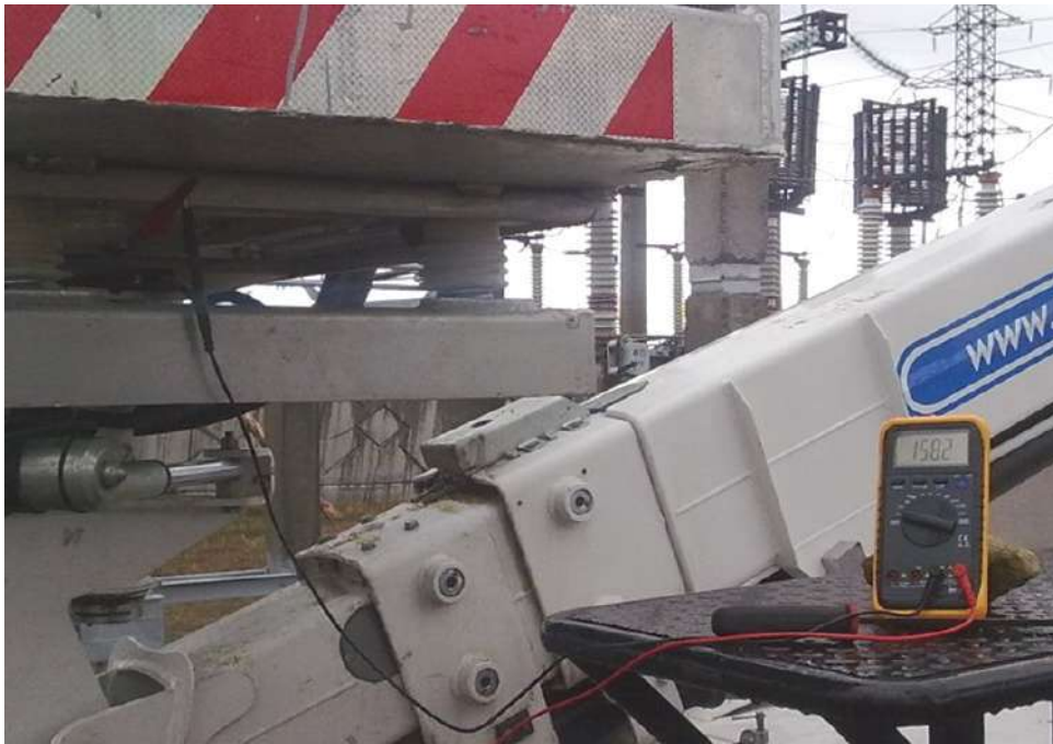
Рисунок 1.2 – Наведенное напряжение на изолированной корзине автоподъемника, расположенного в РУ-110 кВ, составило более 158 В
