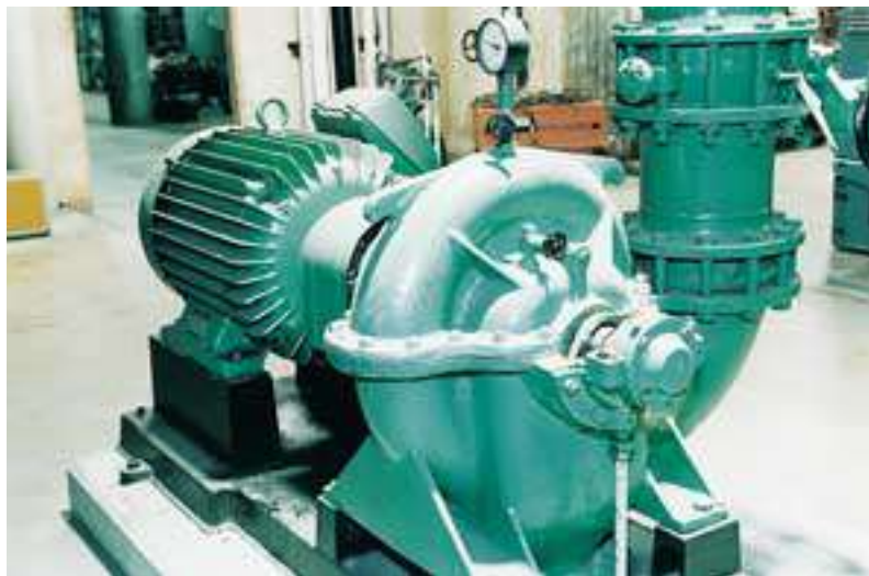
Использование в системах насосов
