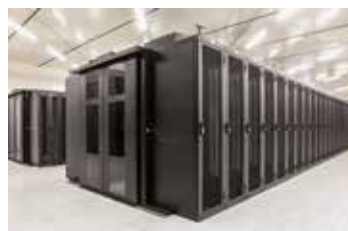
Конструкции холодных коридоров Minkels для охлаждения IT оборудования
